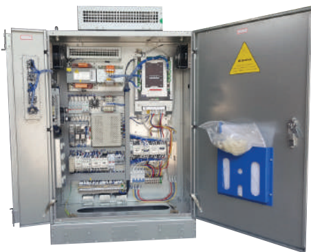
TỦ ĐIỆN STEP THAILAND
